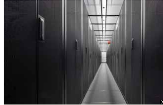
X Herzkammer der Forschung: der neue Serverraum beherbergt die zentrale Datentechnik des Instituts.
